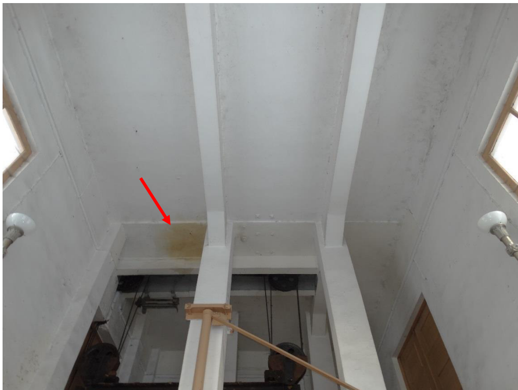
Рисунок Д.27. Масляная протечка (по перекрытию на отм. 136,830)
