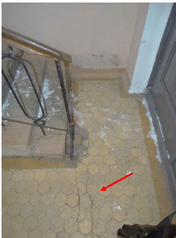
Рисунок Д.8. Загрязнено / повреждено напольное покрытие из метлахской плитки
