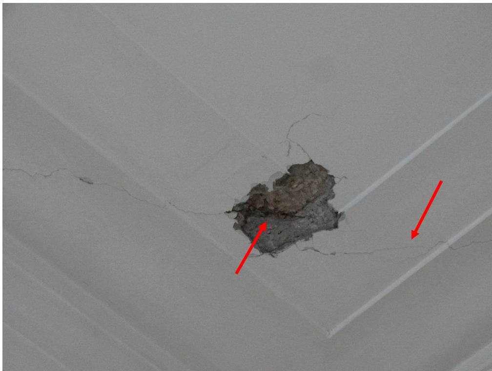
Рисунок Д.19. Наклонная трещина в плите перекрытия на отм. 145,100 в осях 1-2 / С-Д шириной раскрытия 0,2 мм длиной 1,9 м
