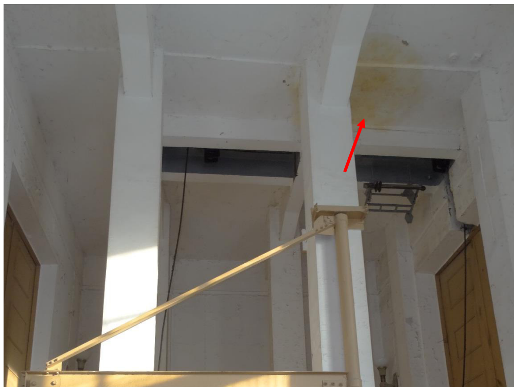
Рисунок Д.24. Масляная протечка (по перекрытию на отм. 136,830)
