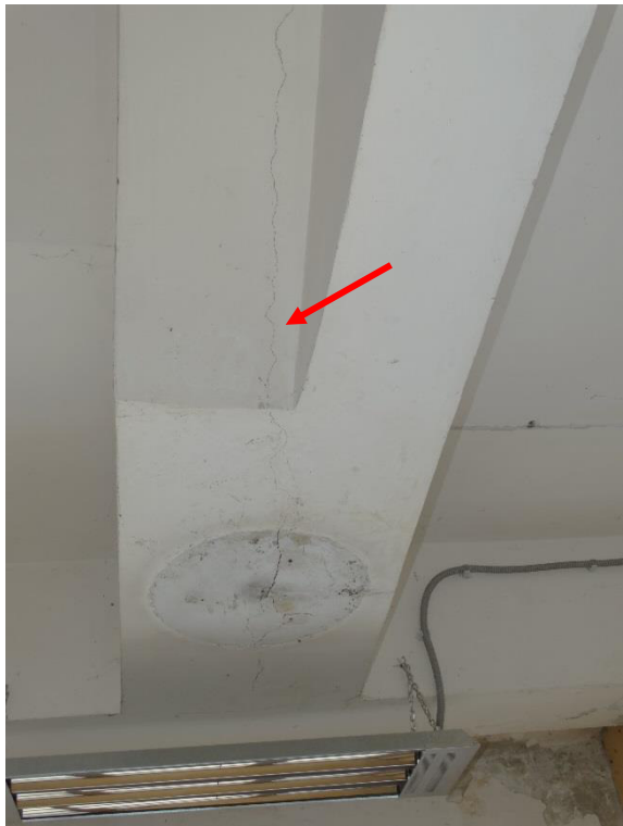
Рисунок Д.3. Вертикальная трещина на стыке косоура и лестничной площадки шириной раскрытия 0,3 мм длиной 1,7 м
