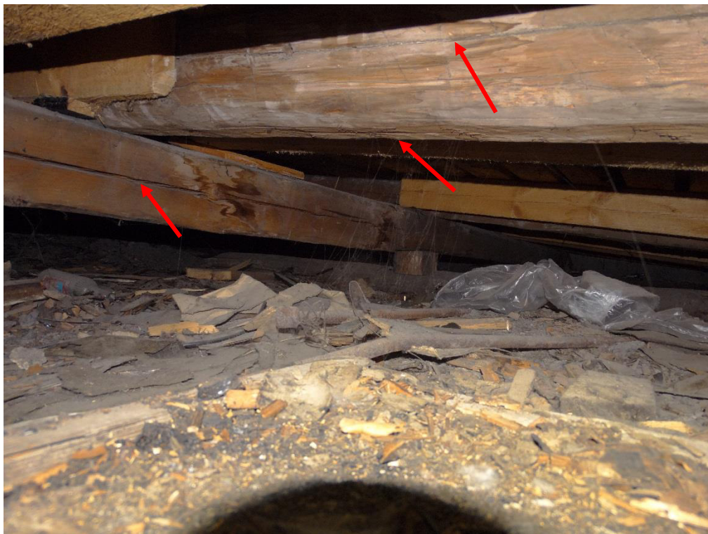
Рисунок Д.5. Изменение цвета (побурение), высыхание и растрескивание конструкций стропильной системы
