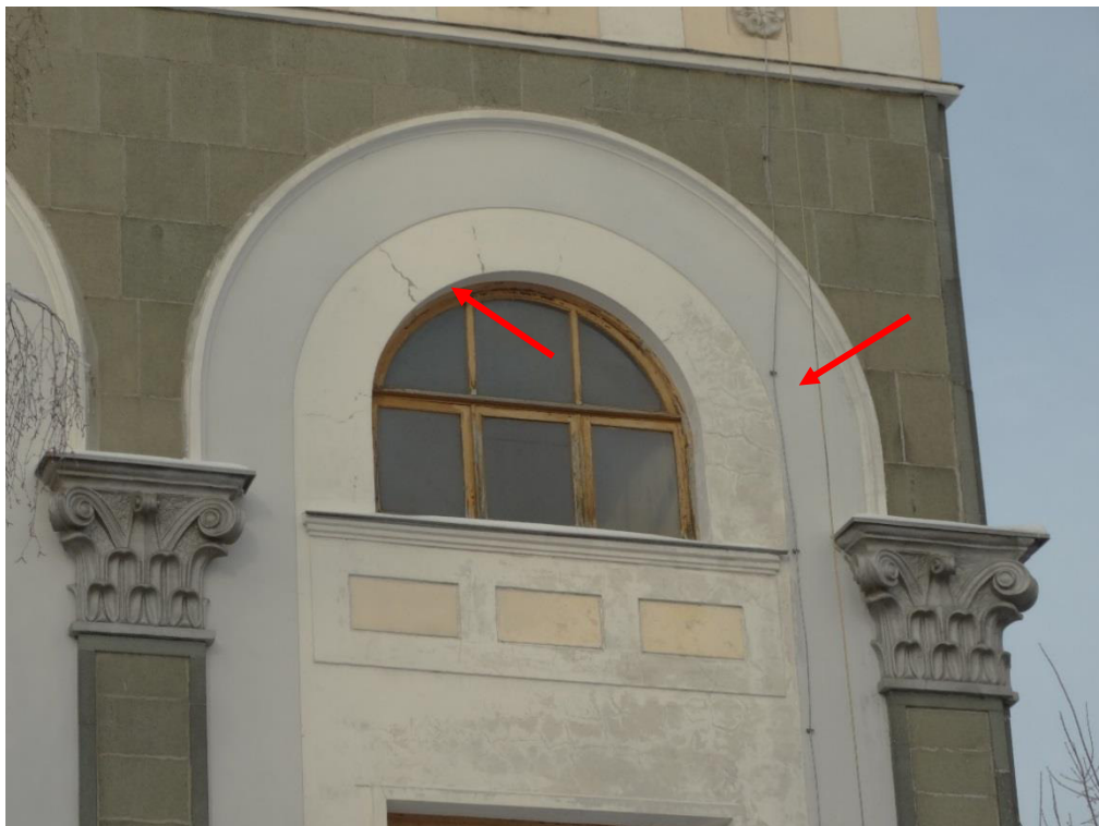
Рисунок Д.47. Наклонные трещины (4 шт.) в кирпичной кладке над оконным проемом шириной раскрытия до 1,0 мм, общей длиной до 3,5 м. Отслоение отделочного лакокрасочного покрытия, сетка трещин по штукатурному слою на площади до 7,5 м 2
