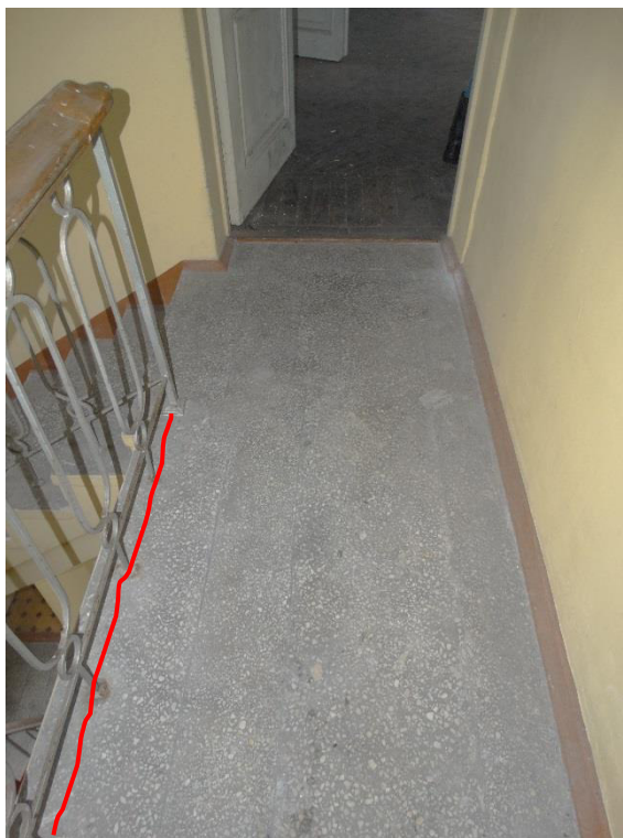
Рисунок Д.17. Вертикальная трещина в лестничной площадке на отм. 140,860 шириной раскрытия 0,6 мм длиной 1,8 м (в местах заделки стоек перил)
