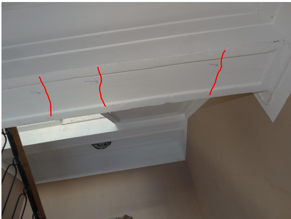
Рисунок Д.13. Вертикальные трещины в балке лестничной площадки на отм. 135,560 шириной раскрытия 0,2 мм длиной 0,3 м
