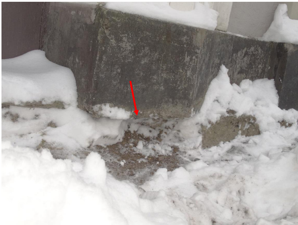
Рисунок Д.37. Просадка грунта до 15,0 см, длина участка 10,5 м, разрушена отмостка
