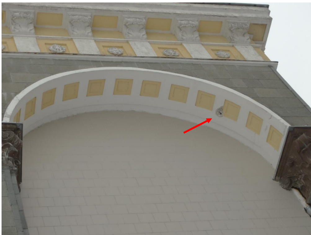
Рисунок Д.34. Скол бетона арки без оголения рабочей арматуры S=0,07 \text{ м}^2
