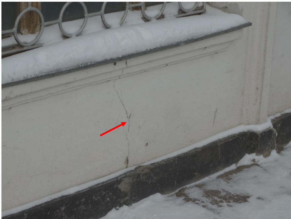
Рисунок Д.31. Вертикальная сквозная трещина в кирпичной кладке под оконным проемом шириной раскрытия до 1,5 мм, длиной до 1,2 м
