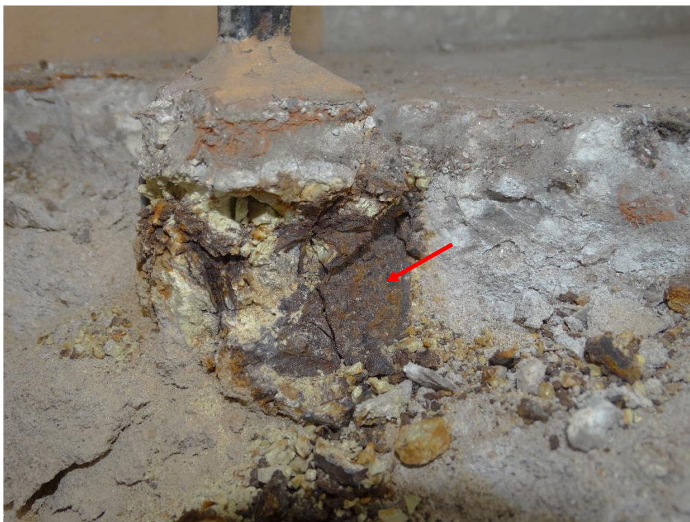
Рисунок Д.2. Пластовая коррозия стоек перил. Толщина продуктов коррозии \Delta=2,0 см
