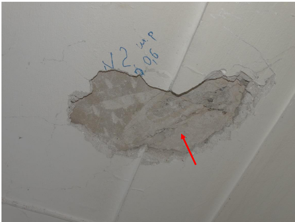
Рисунок Д.7. Наклонная трещина в плите перекрытия на отм. 140,900 в осях 1-2 / С шириной раскрытия 0,6 мм длиной 1,7 м
