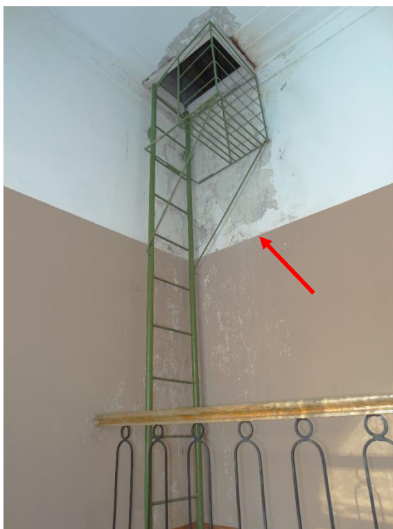
Рисунок Д.14. Протечки. Солевая коррозия кирпичной кладки
