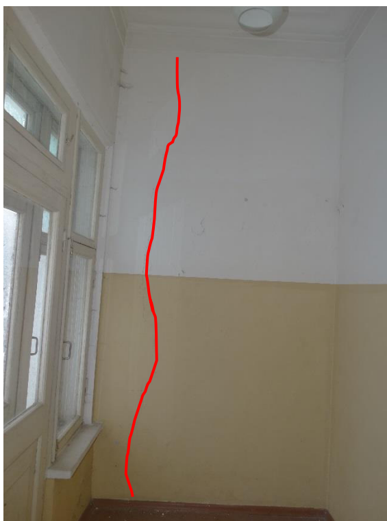
Рисунок Д.18. Вертикальная трещина в кирпичной кладке (от отм. 136,830) шириной раскрытия 0,6 мм длиной 4,0 м
