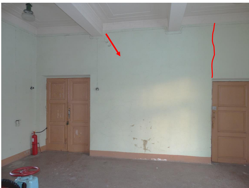
Рисунок Д.28. Вертикальная трещина в кирпичной кладке (от отм. 139,800) шириной раскрытия 0,3 мм длиной 1,0 м. Сетка трещин шириной раскрытия до 0,3 мм в штукатурном слое стены (между отм. 136,830 – 140,870)
