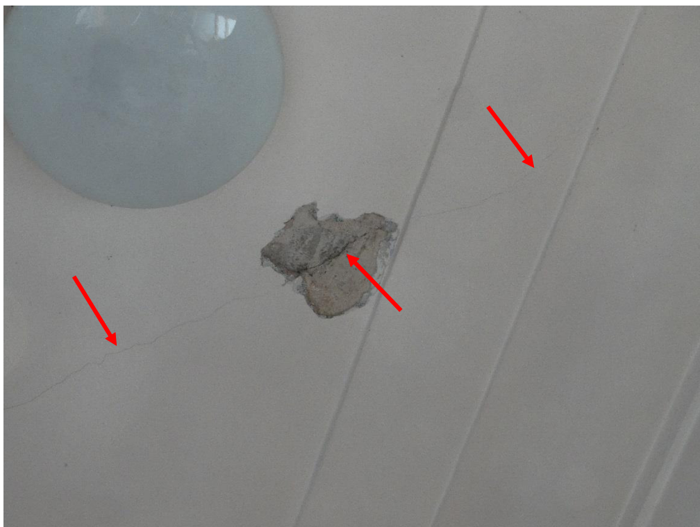
Рисунок Д.12. Наклонная трещина в плите перекрытия на отм. 145,170 в осях 1-2 / А шириной раскрытия 0,4 мм длиной 1,5 м
