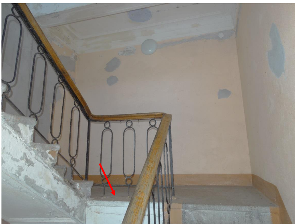
Рисунок Д.22. Скол лестничной площадки в местах заделки перил глубиной 7,0 см. Пластовая коррозия стоек перил. Толщина продуктов коррозии \Delta=2,0 см
