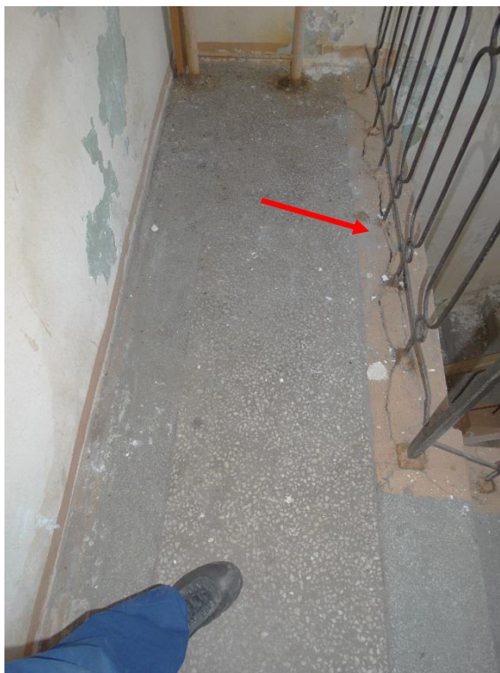
Рисунок Д.25. Скол лестничной площадки в местах заделки перил глубиной 7,0 см
