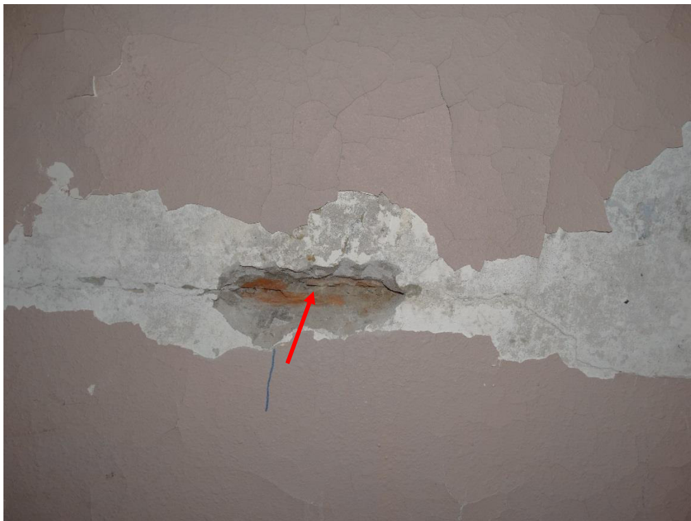
Рисунок Д.23. Горизонтальная трещина по шву кирпичной кладки на отм. 135,700 шириной раскрытия 0,6 мм длиной 2,0 м
