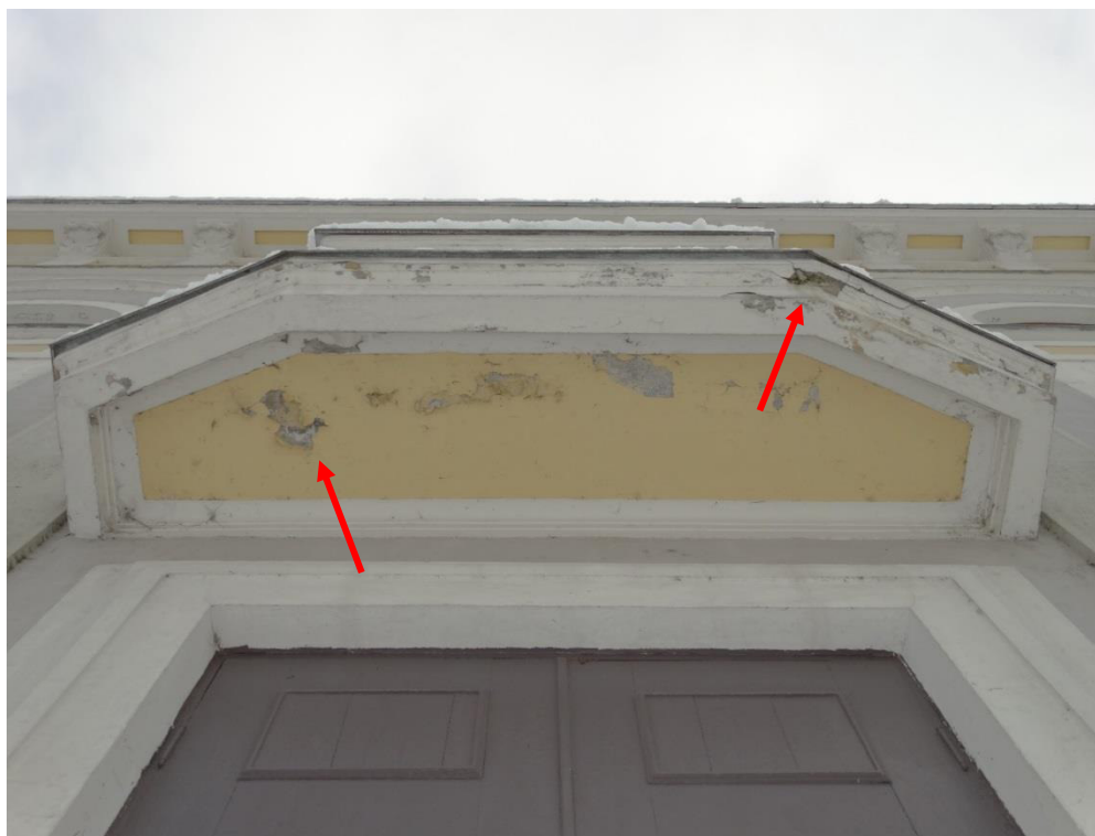
Рисунок Д.39. Сколы по отделке балконов, отслоение отделочного штукатурного слоя по нижней грани балконов (3шт.) Собщая=7,5 м 2
