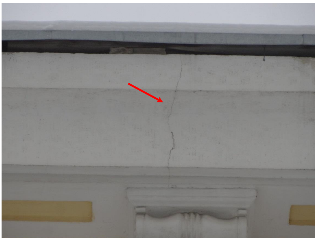
Рисунок Д.30. Вертикальные трещины (5 шт.) в железобетонном парапете шириной раскрытия до 1,0 мм, общей длиной до 3,5 м
