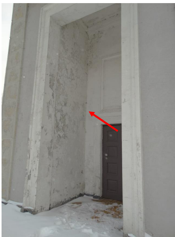
Рисунок Д.40. Отслоение отделочного лакокрасочного покрытия на площади до 14,0 м 2
