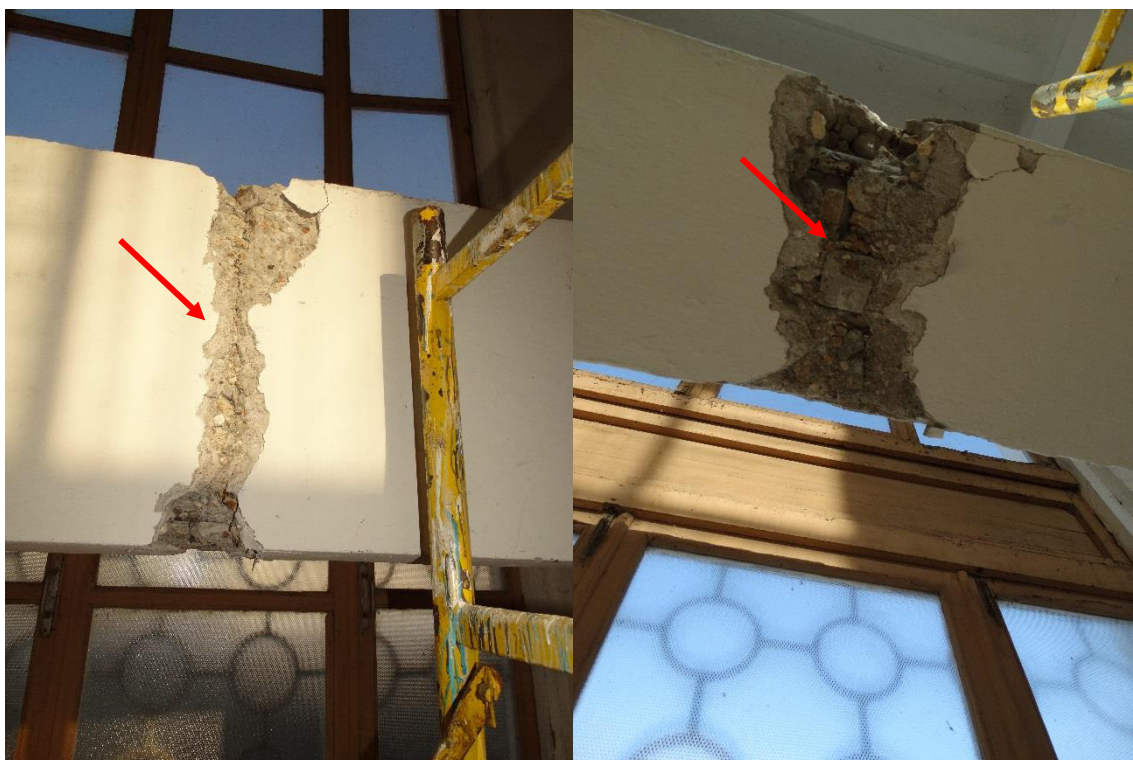
Рисунок Д.10. Вертикальная сквозная трещина в середине пролета подкрановой балки по осям 2-3 / С шириной раскрытия 0,8 мм длиной 0,5 м. Скол бетона балки глубиной 5 см (Вид сбоку, вид снизу)
