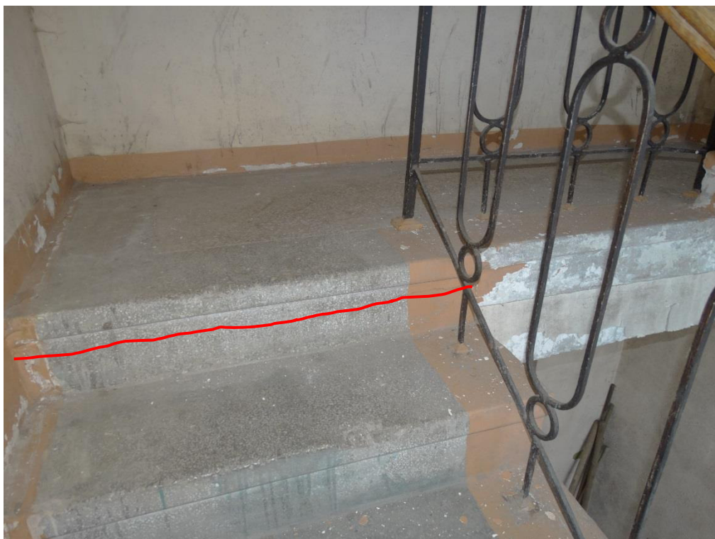
Рисунок Д.26. Горизонтальная трещина в ступени на отм. 133,040 шириной раскрытия 0,3 мм длиной 1,0 м
