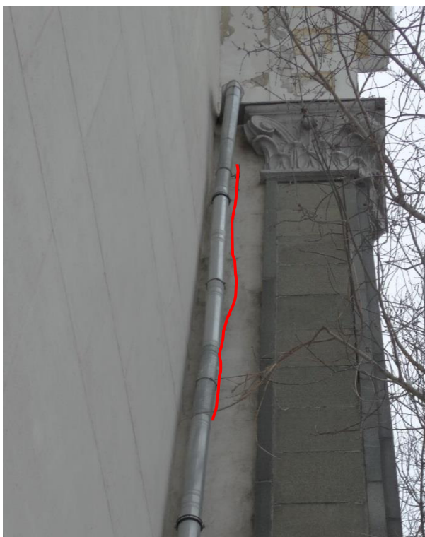
Рисунок Д.42. Вертикальная трещина в кирпичной кладке пилона шириной раскрытия до 1,0 мм, длиной до 5,0 м
