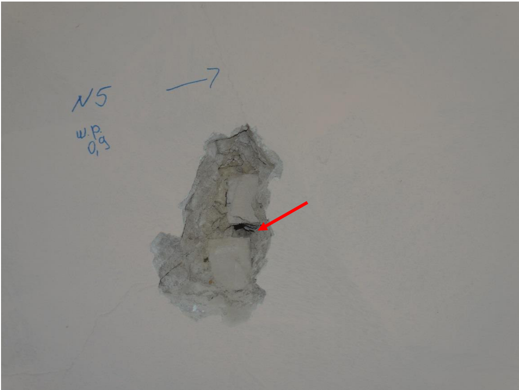
Рисунок Д.4. Вертикальная трещина в кирпичной кладке шириной раскрытия 0,9 мм длиной 2,0 м. Пустоты в швах. Кладка стены по оси 4 выполнена из силикатного кирпича
