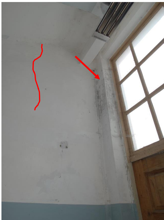
Рисунок Д.9. Вертикальная трещина в кирпичной кладке шириной раскрытия 0,3 мм длиной 1,0 м (от отм. 133,200). Протечки по стене
