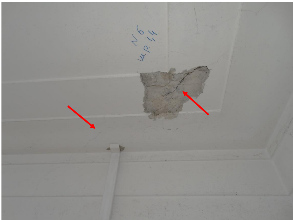
Рисунок Д.15. Наклонная трещина в плите перекрытия на отм. 140,870 в осях 1-3 / Д шириной раскрытия 1,4 мм на глубину защитного слоя длиной 2,3 м
