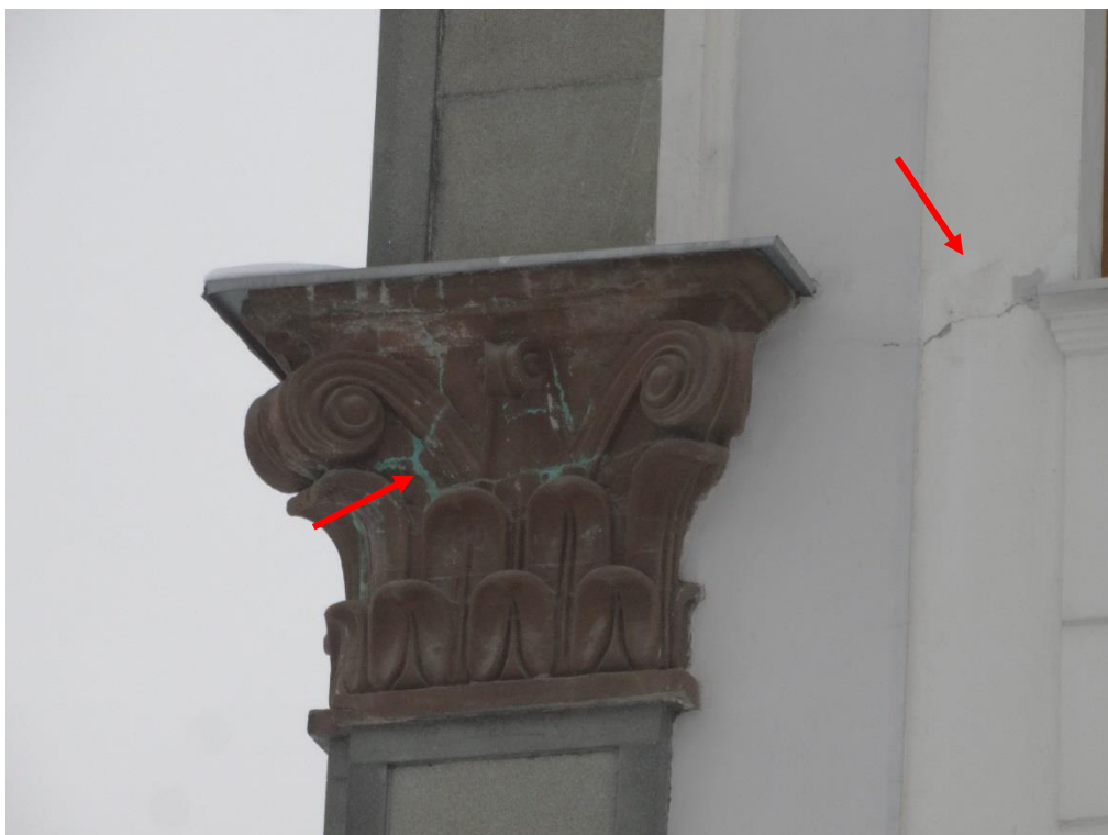
Рисунок Д.32. Сетка трещин на капители. Наклонные трещины (2 шт.) в кирпичной кладке по углам оконного проема шириной раскрытия до 1,0 мм, общей длиной до 1,5 м
