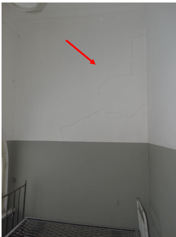
Рисунок Д.20. Сетка трещин шириной раскрытия до 0,3 мм в штукатурном слое перегородки (между отм. 142,000 – 145,100)
